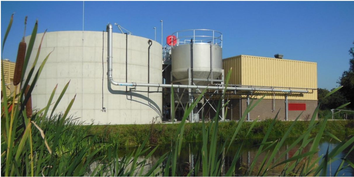
Afbeelding 3. Deelstroombehandeling rwzi Land van Cuijk. Van links naar rechts: DEMON ® -reactor, NuReSys struvietterugwinning en het bedrijfsgebouw. Leidinglengtes zijn kort gehouden. Daarnaast voorkomt de materiaalkeuze aanhechting van struviet en turbulentie (foto: Bart Verberkt, Waterschap Aa en Maas).
