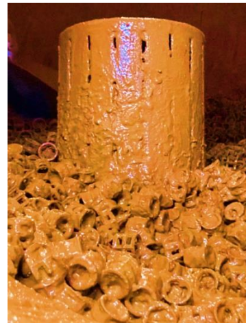
Afbeelding 2. IJzer- en biomassa-ophoping in pallringen en beluchtingspyloon van een beluchtings- en ontgassingstoren op PS Breehei
