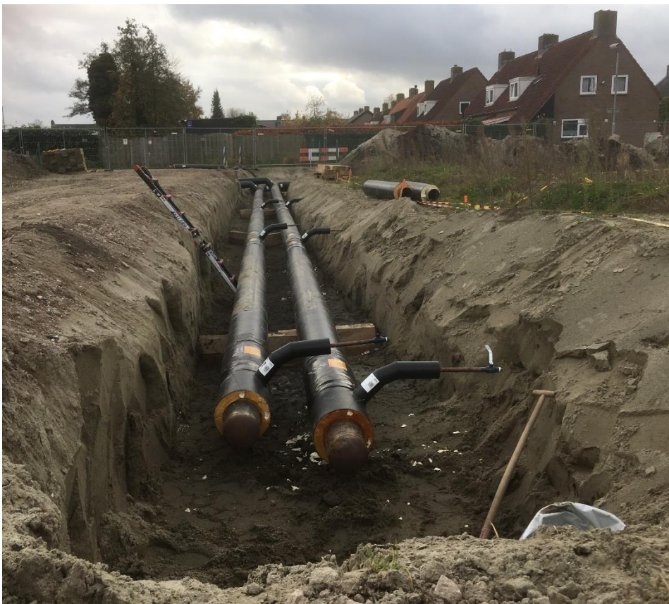
Afbeelding 2. Een warmtenet in aanleg, locatie Terheijden, gemeente Drimmelen (foto: KWR, Jip van der Steen)
