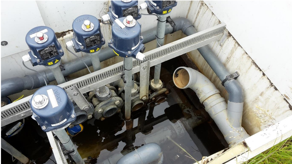
Afbeelding 1. In de regelput wordt het elektrisch geleidingsvermogen van het drainagewater bepaald. Bij waarden lager dan 1,3 mS/cm wordt het water opgeslagen in het bassin. Via deze put wordt eveneens water het veld ingebracht in droge perioden via de bestaande drainage. Het niveau kan worden gestuurd met elektrische kleppen, afhankelijk van de waterbehoefte van het gewas.
