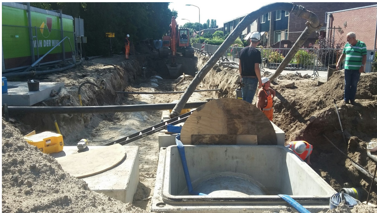
Afbeelding 5. Aanleg van Ø 1000 rwa-leiding naast een nieuw vuilwaterriool in fase 1 van maatregel 2.
